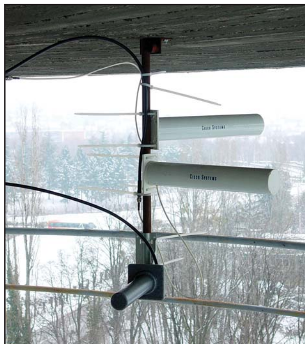
Slika 3. Antene bežične mreže na računalno komunikacijskom tornju Instituta
